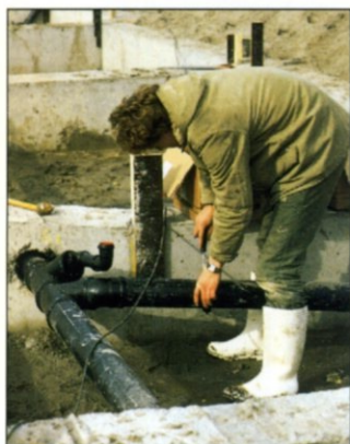
Binnenriolering: PPC-buizen vervangen het gebruikelijke PVC.
