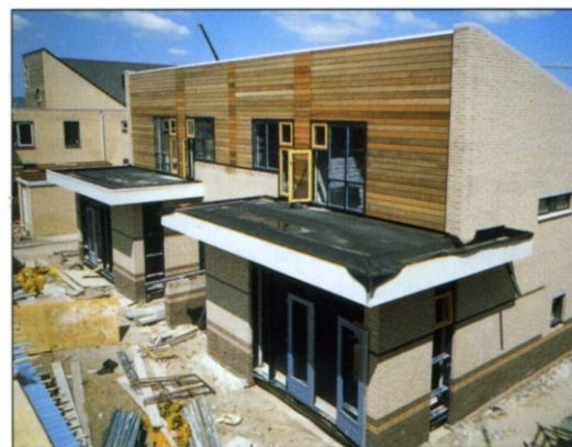
Dakbedekking: Los gelegd op platte daken en geballast voldoet EPDM-folie aan alle gestelde verwachtingen. Geheel onverwacht deden zich condensatieproblemen voor bij op houten constructies geplakt EPDM.
